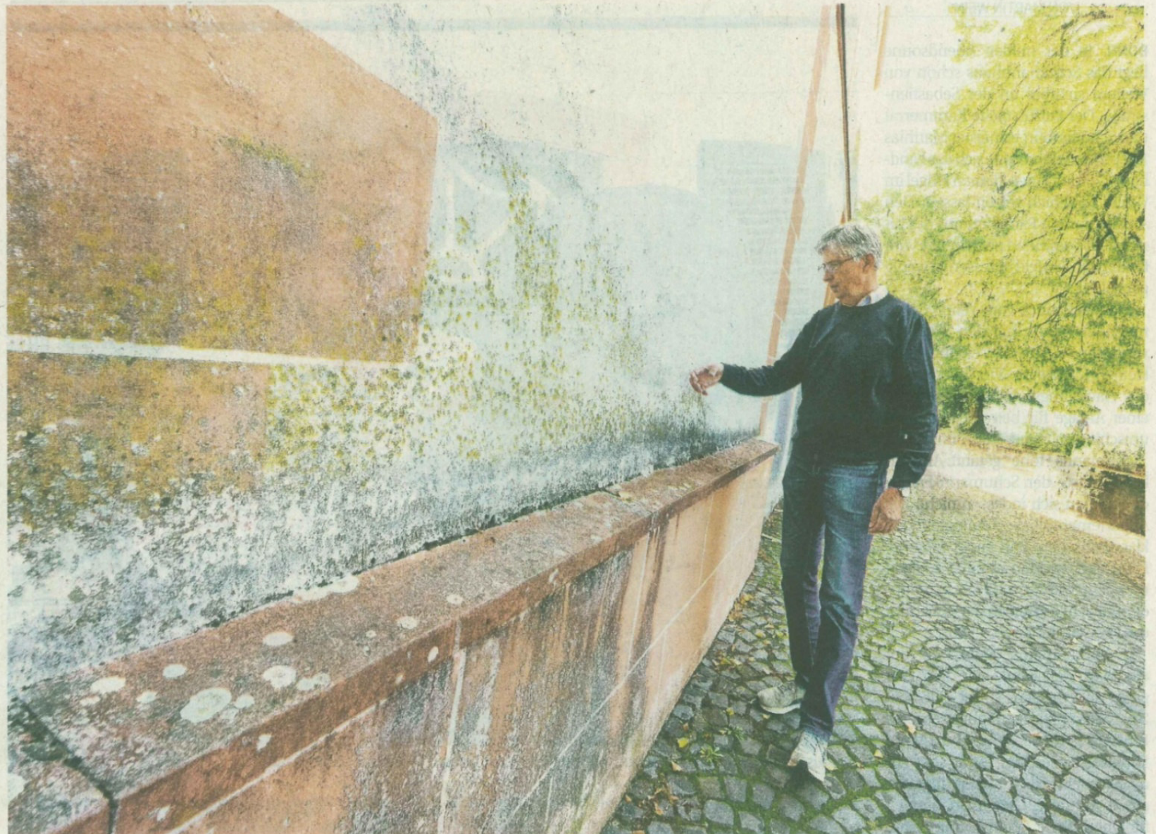
Von der Fassade der Kirche bröckelt der Putz ab und klopft man an die Wand, ertönt ein dumpfer Ton. Die aufsteigende Feuchtigkeit zerstört das Mauerwerk von Sankt Laurentius immer mehr, erklärt Bauingenieur Bernd Kremser.
